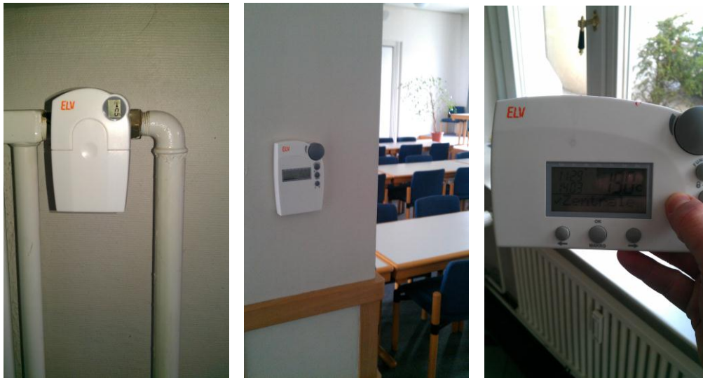
Abbildung 6-29: Funksteuerung der Heizungsanlage in der Anshar-Kirchengemeinde Neumünster (Sensor am Heizkörper, Raumsteuerung, Programmiererelement)
